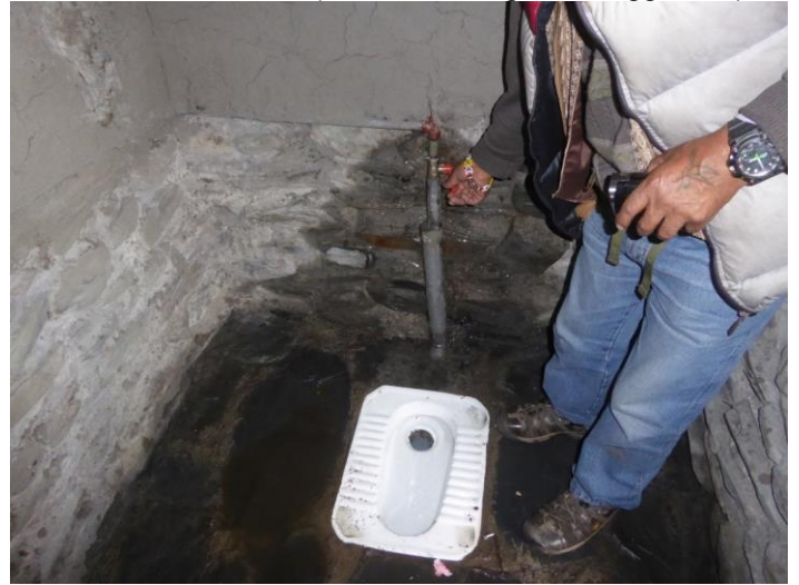
Wasseranschluss von innen, mit einem einfachen Drehhahn versehen (ist noch nicht ganz fertiggestellt).
